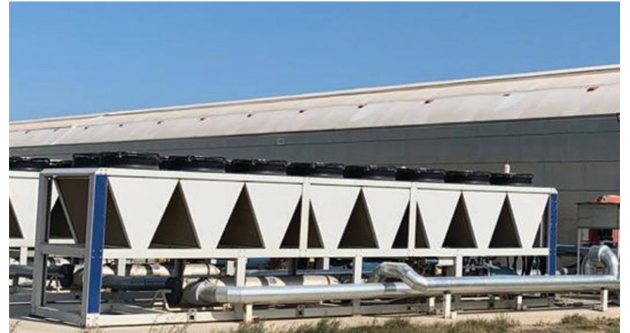
CHILLER UNITE / ХОЛОДИЛЬНЫЕ УСТАНОВКИ
